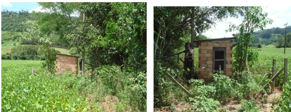
Figura 8.10 E 8.11 – Poço profundo – linha Formosa
