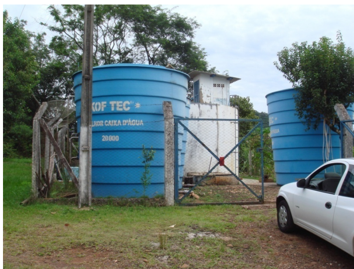
Figura 8.5 - Reservatórios capacidade 130 m 3
